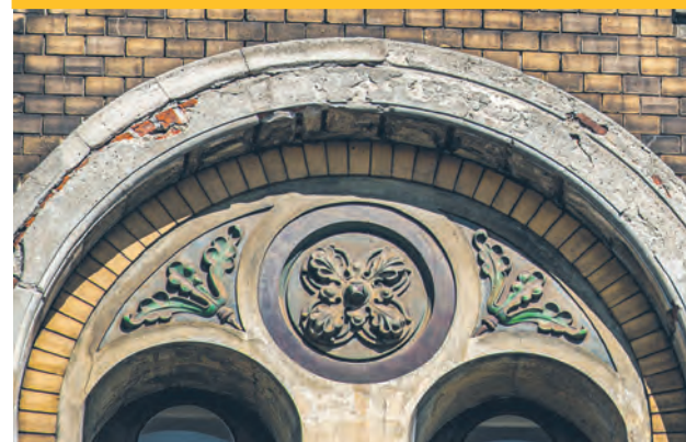
Detal architektoniczny eklektycznej kamienicy Chaima Mordki i Gersza Auerbachów przy ul. Narutowicza 32, zbudowanej w 1896 r.
